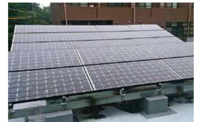
店舗屋根に設置された太陽光パネル
