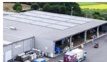
本社工場の屋根に設置されている太陽光パネル
